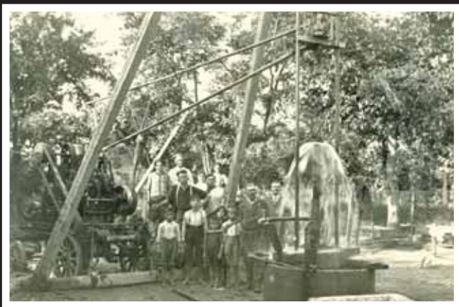
Perforazione di un pozzo artesiano della ditta Sante Santachiara di Carpi, anni Venti
